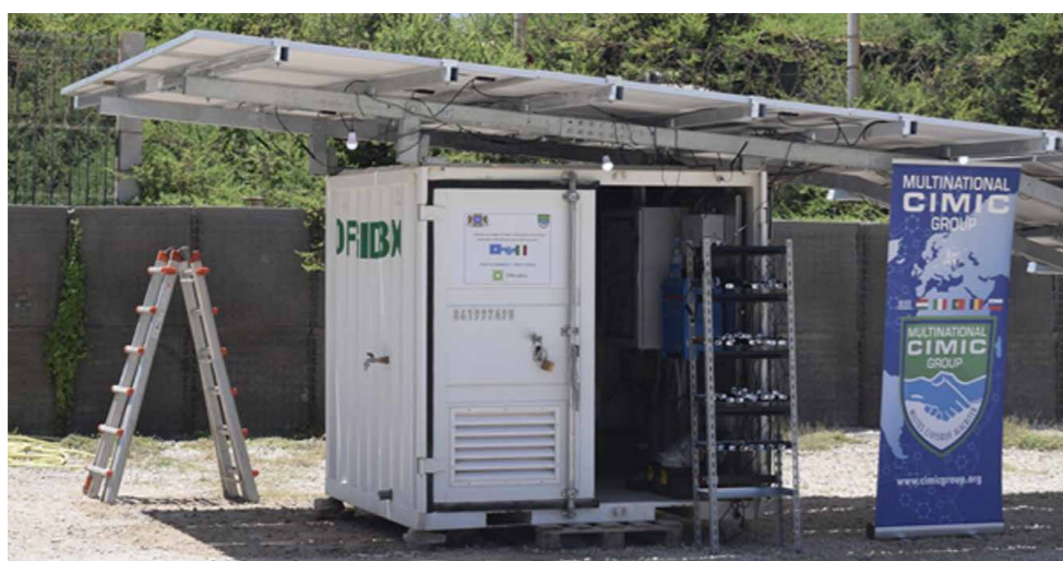
Figura 22: Un box di La Fabbrica del Sole con soluzioni SECO installato in Somalia
