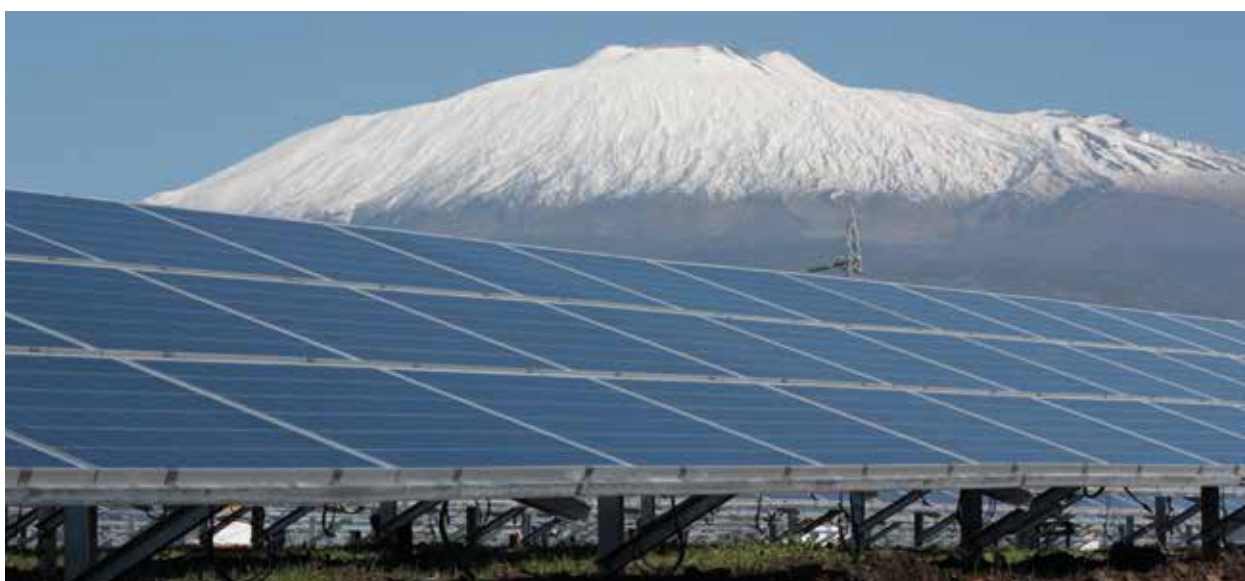
Impianto fotovoltaico di Cardonita-Centuripe (Enna)
