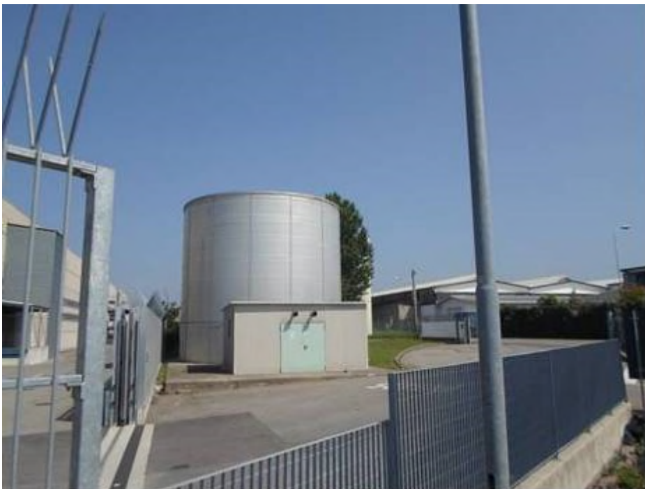
Serbatoio per impianto sprinkler
