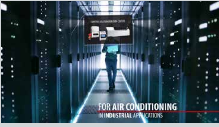
Applicazioni nel campo del condizionamento dei Data Center
