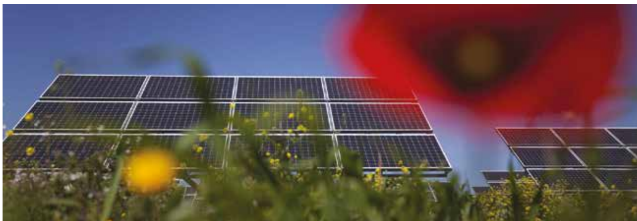
Impianto fotovoltaico di Notarpanaro (Solar Mesagne - Brindisi)
