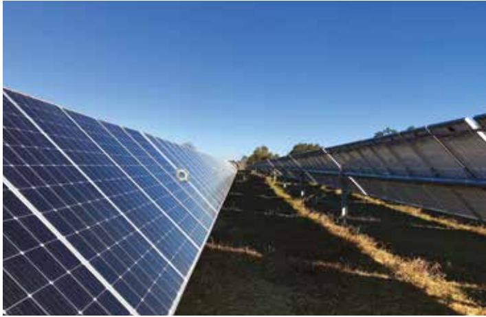
Impianto fotovoltaico IS42 (North Carolina - USA)
