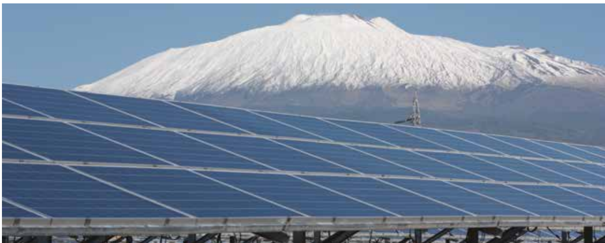
Impianto fotovoltaico di Cardonita-Centuripe (Enna)
