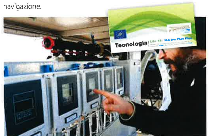
Centralina di controllo _ Sperimentazione Porto di Cervia , Italia
