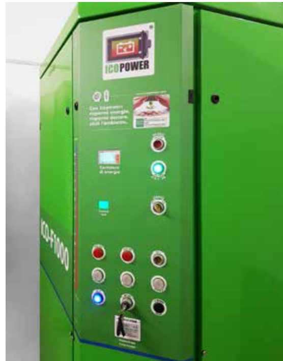
Apparecchiatura ICO-F1000 installata nel sito logistico "Cavenago A"
