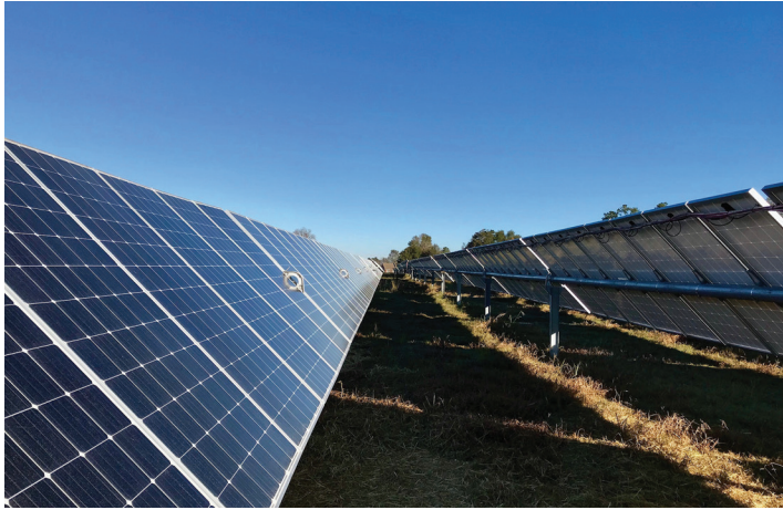
Impianto fotovoltaico IS42 (North Carolina - USA)
