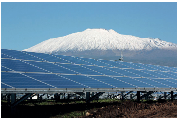
Impianto fotovoltaico di Cardonita-Centuripe (Enna)
