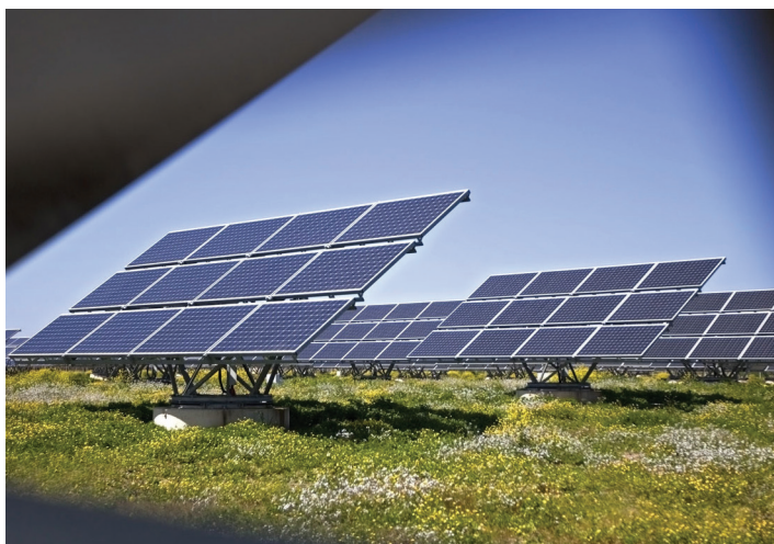
Impianto fotovoltaico di La Calce (Solar Mesagne-Brindisi)
