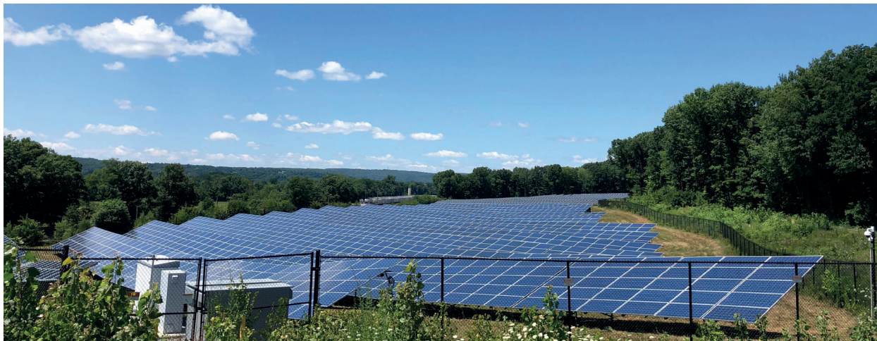
Impianto fotovoltaico di Leominster (USA).
