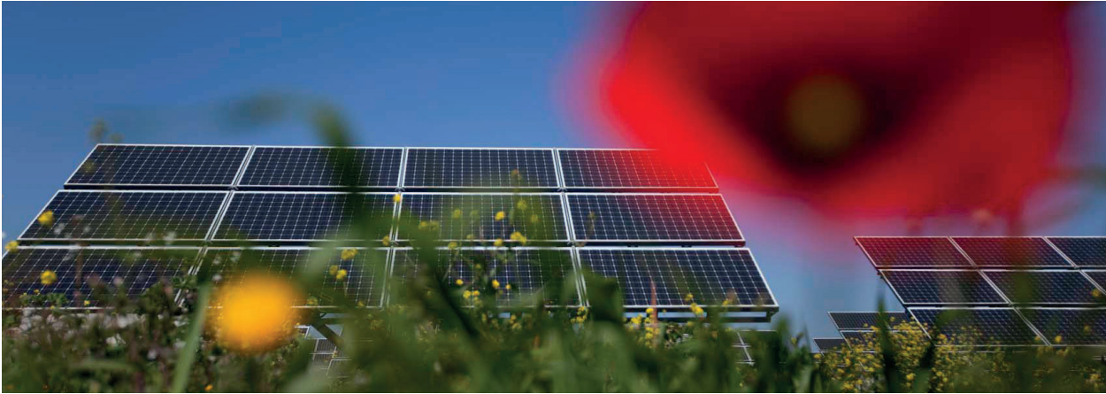
Impianto fotovoltaico di Notarpanaro (Solar Mesagne - Brindisi)
