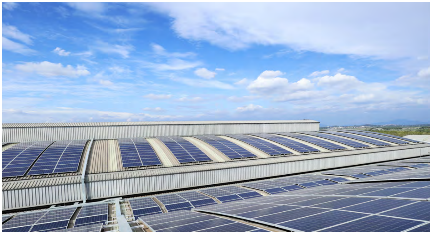
Impianti fotovoltaici presso il polo tecnologico di Empoli
