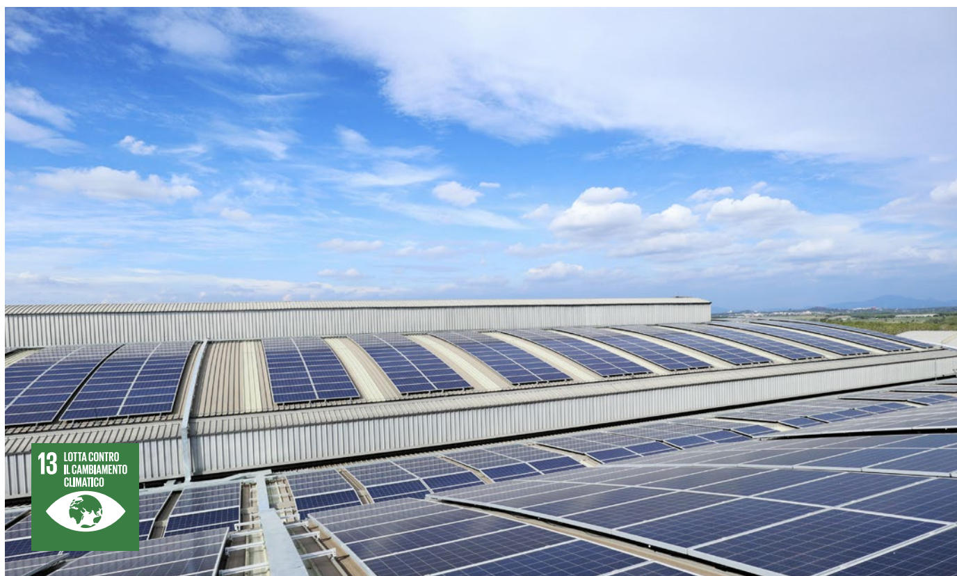
Impianti fotovoltaici presso il polo tecnologico di Empoli
