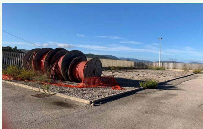
Area di installazione nella sottostazione
